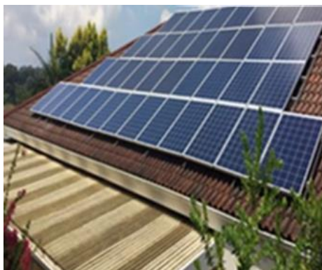
Figura 9 – Shembull i instalimit të paneleve solare fotovoltaike me fuqi 10 kW në Itali
